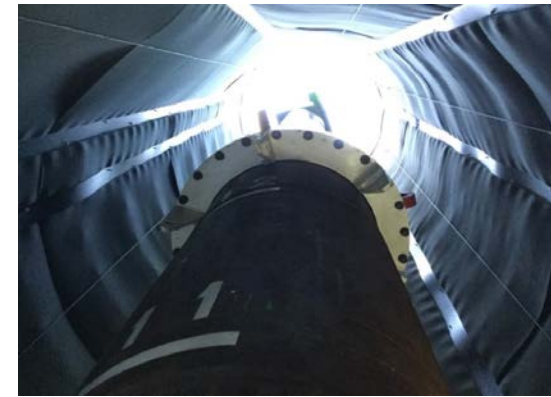
上部防音室内部(設置後)
