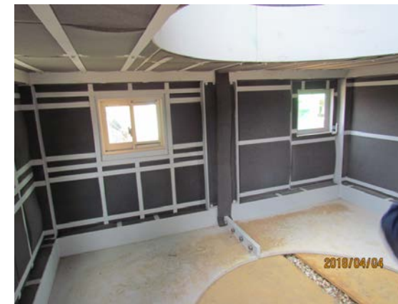
下部防音室の内部
