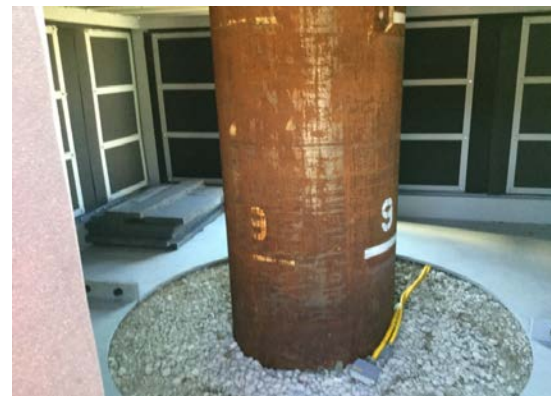
下部防音室内部(設置後)
